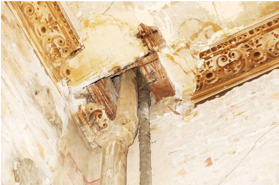
Abbildung 9: Detail nicht fachgerecht abgedichtete Rohrdurchführung
