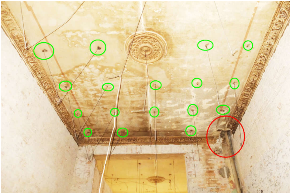
Abbildung 8: Deckenuntersicht im Gastraum einer Rauchergaststätte nach Entfernen der Deckenverkleidung, Perforationen des Deckenputzes durch Abhänger grün umrandet. Rote Umrandung: nicht fachgerecht abgedichtete Rohrdurchführung
